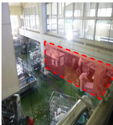
写真 1：区画壁が無い（調理室と洗浄室）
