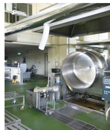
写真9：スポットクーラー吹出口
