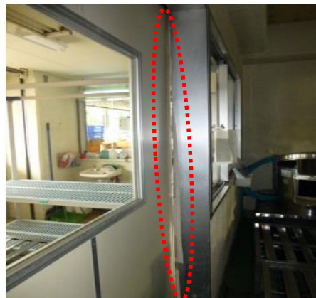
写真8：検収室の建具に生じた隙間
