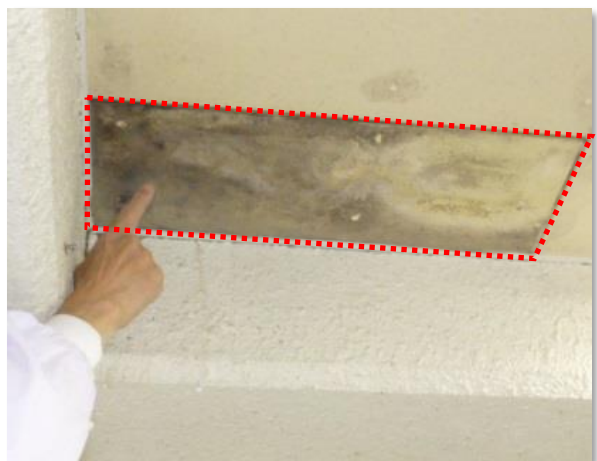
写真 6-4：天井の雨漏り
