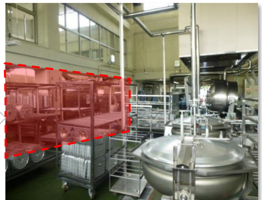
写真 2：区画壁が無い
