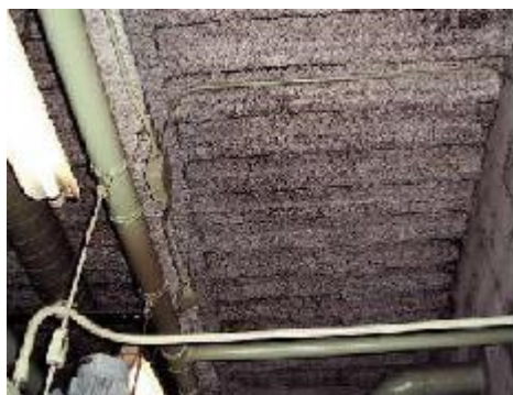
石綿含有吹付けロックウール
