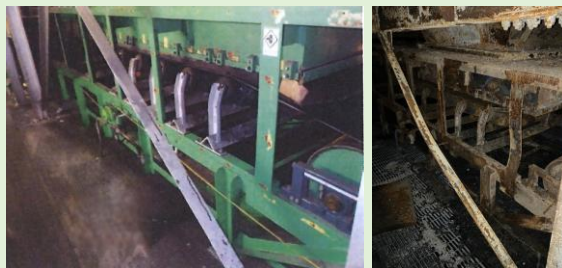
▲破碎物搬送コンベヤ（通常時・焼損時）
