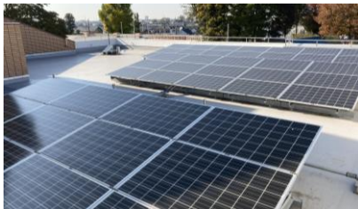
▲太陽光パネル
