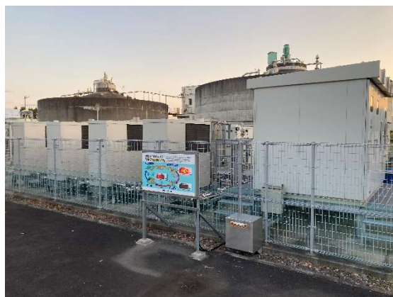
写真：消化ガス発電施設（守谷浄化センター）
