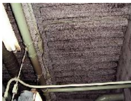
石綿含有吹付けロックウール
