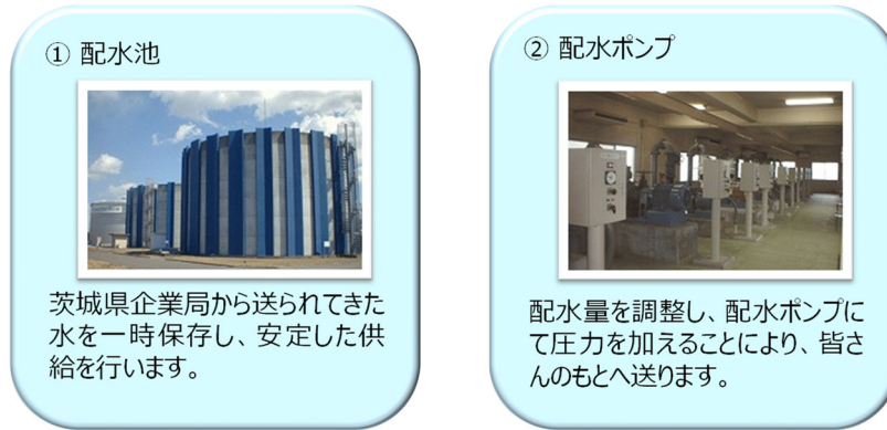
図 2.4 守谷市の水道施設
