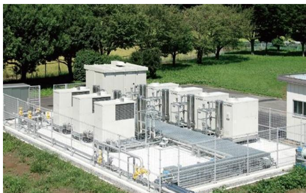
消化ガス発電施設
