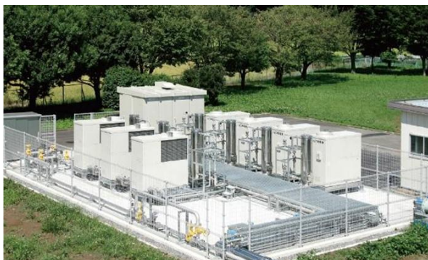
消化ガス発電施設
