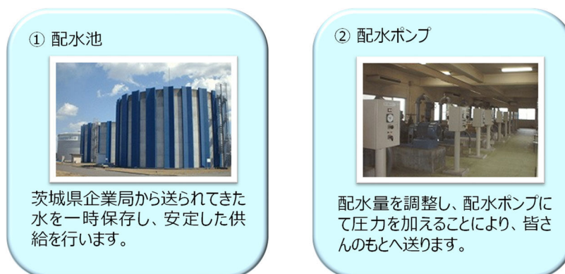
図 2.4 守谷市の水道施設
