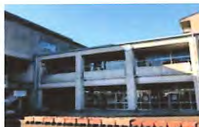
老朽化した外壁
