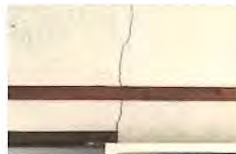
老朽化した内壁
