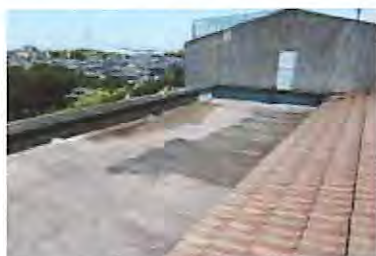
屋根防水の劣化状況
