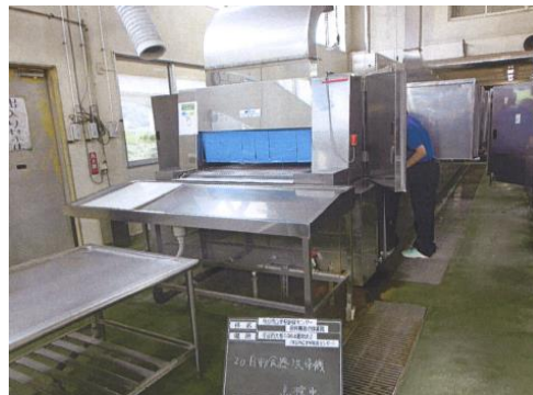
食器洗浄機の定期点検
