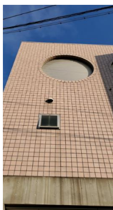
▲タイルの汚れや剥がれ
