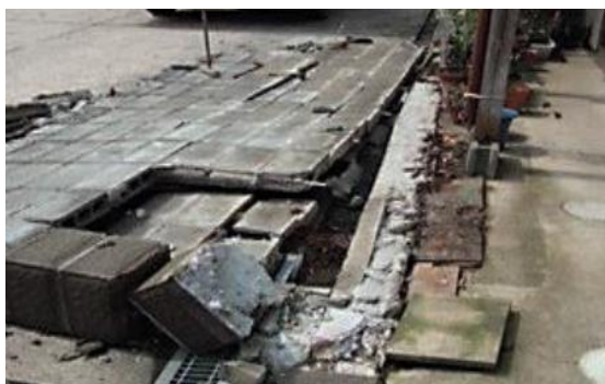
倒壊したブロック塀(参考写真)
