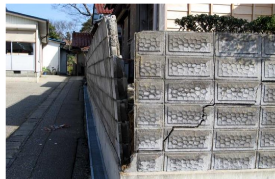
危険なブロック塀(参考写真)
