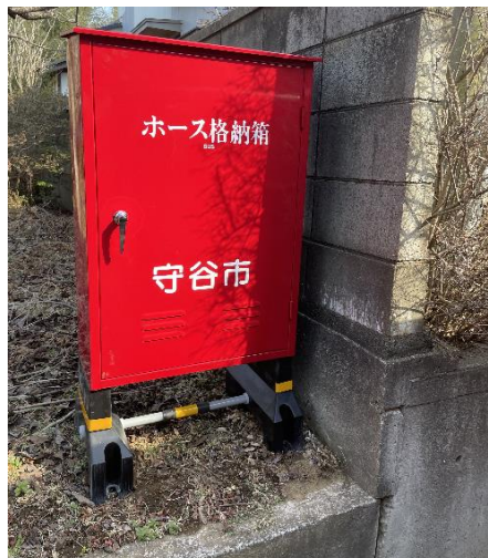
消火栓用消防用具格納箱
