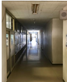
廊下の劣化状況
