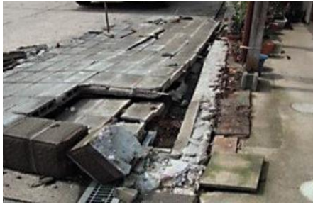
倒壊したブロック塀
