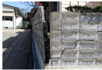
危険なブロック塀
