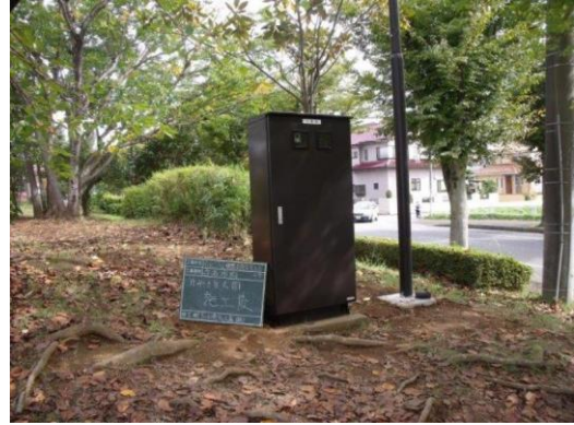
公園・遊歩道灯用分電盤
