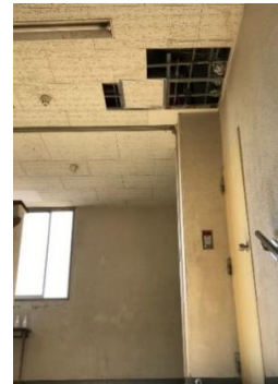
天井板の劣化状況
