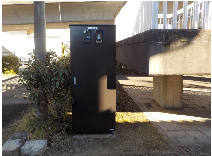
防犯灯用分電盤
