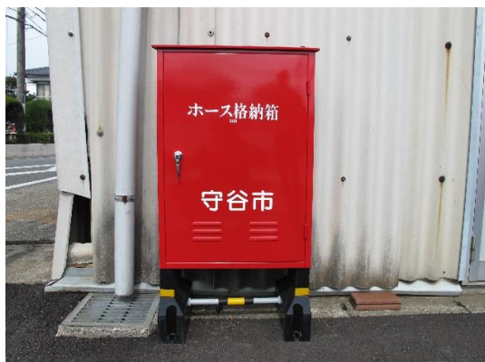
消火栓用消防用具格納箱
