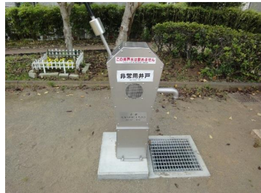
非常用防災井戸
