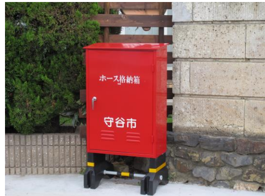
消火栓用消防用具格納箱
