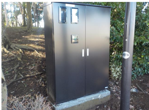
街路灯分電盤
