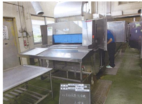
食器洗浄機の定期点検
