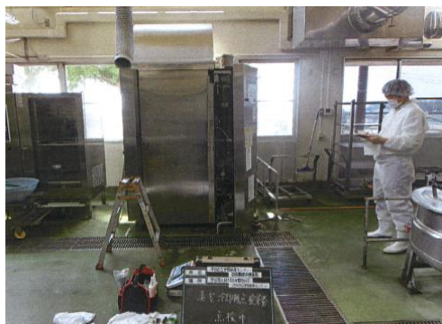
和え物調理で使用する、真空冷却機の 定期点検
