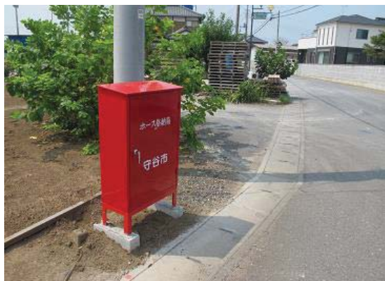
消火栓用消防用具格納箱
