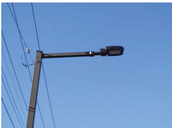
LED道路照明灯
