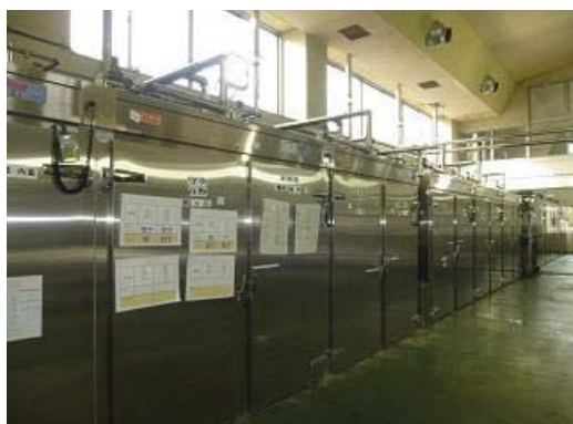
電磁弁や蒸気管等の修繕を定期的に行っている調理機器(写真は熱風保管庫)
