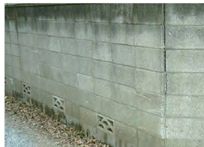
※危険ブロック塀のイメージ
