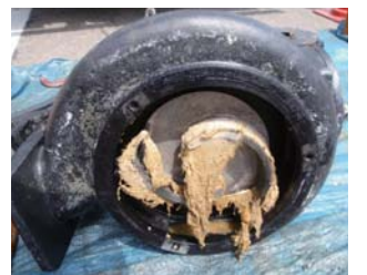
▲タオルの絡まったポンプ
