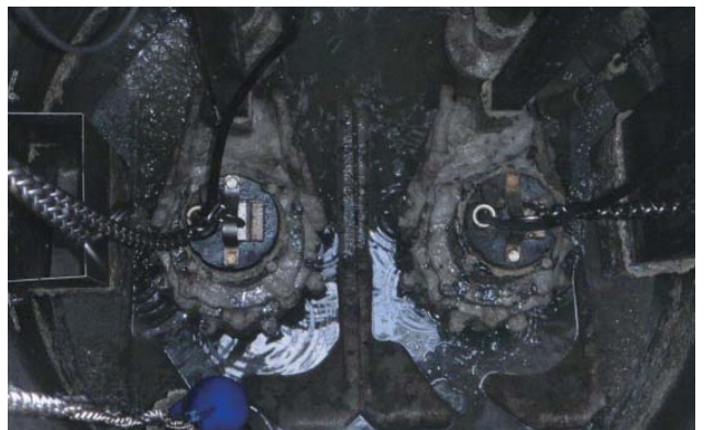
▲油で汚れたマンホールポンプ場内部
