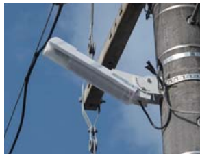
▲電柱に設置された防犯灯
