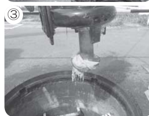
②布などの絡まったポンプ
