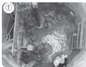
①油で汚れたマンホールポンプ場内部
