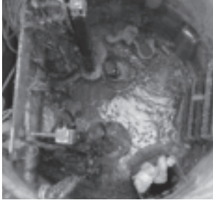
▲油で汚れたマンホールポンプ場内部
