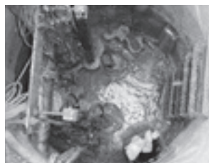
▲油で汚れたマンホールポンプ場内部
