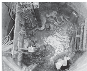
▲油で汚れたマンホール ポンプ場内部
