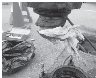
▲布等の絡まったポンプ
