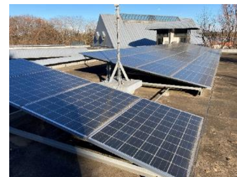
北守谷公民館の太陽光パネル
