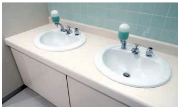
庁舎内のトイレの手洗い場
