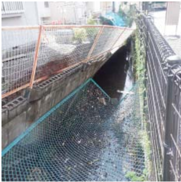
倒壊した南守谷9号雨水幹線（現在は仮復旧済）
