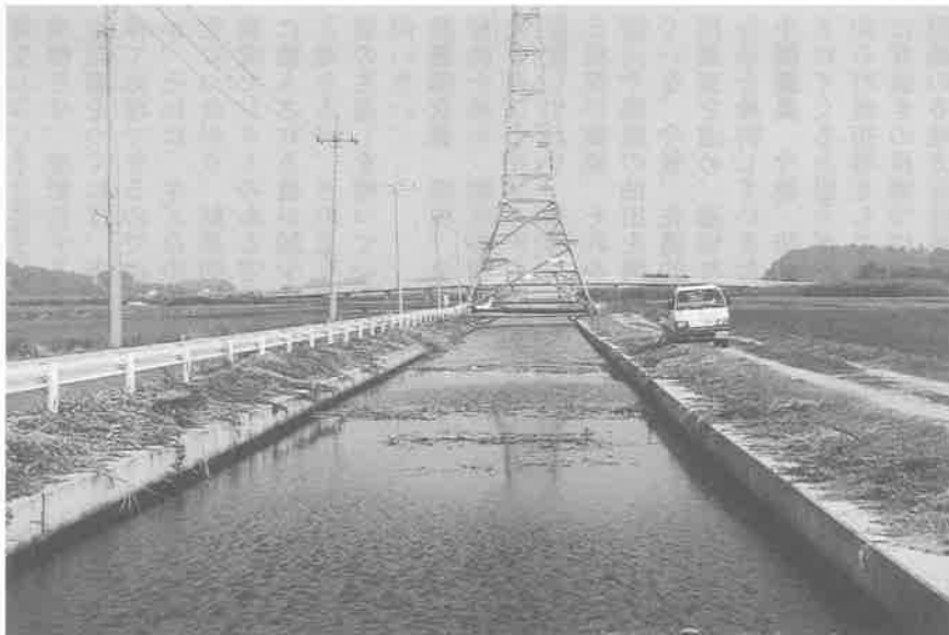
安全対策が急務とされる守谷沼大排水路
