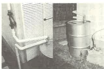
雨水の貯水設備
