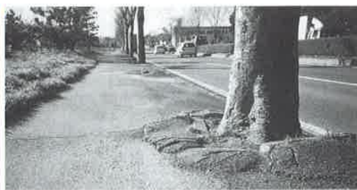
早急な補修工事を！
