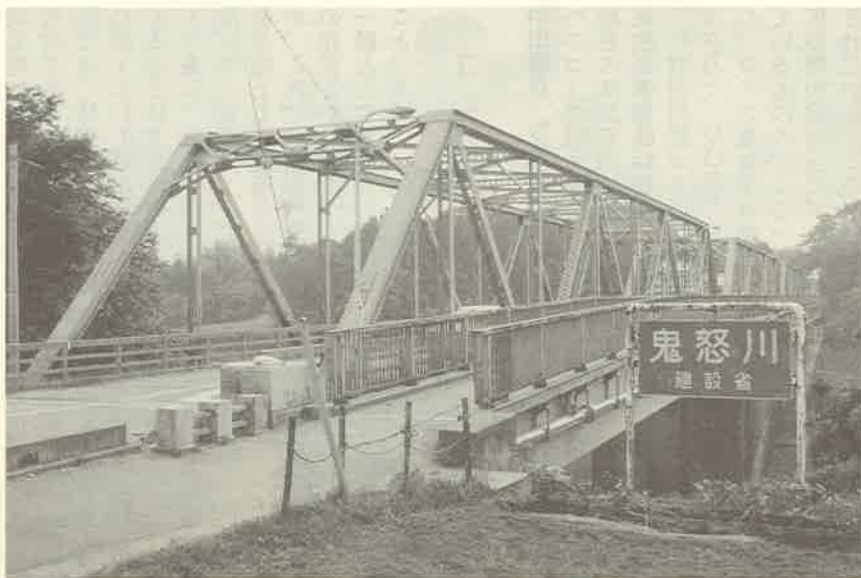
掛け替えが望まれる滝下橋
