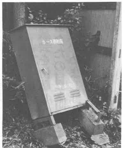
消火栓ボックスの点検整備を！
