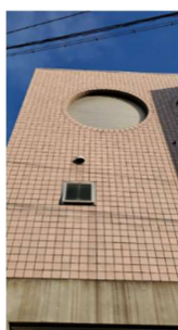
▲タイルの汚れや剥がれ
