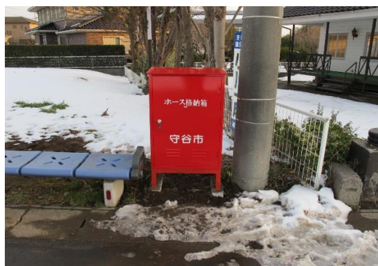
消火栓用器具格納箱
