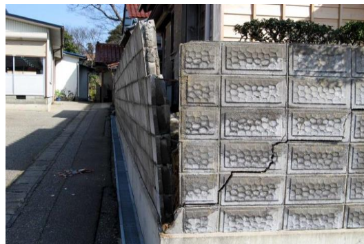
危険なブロック塀(参考写真)
