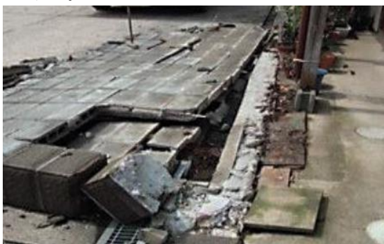
倒壊したブロック塀(参考写真)
