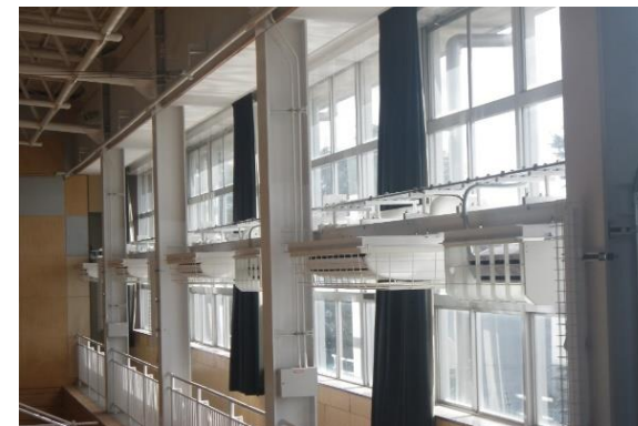
体育館内空調設備
