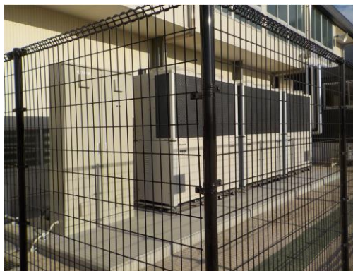
自立発電機能を有するガス空調室外機
