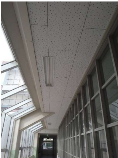
校舎通路の窓から雨水が侵入している形跡が見られる。
