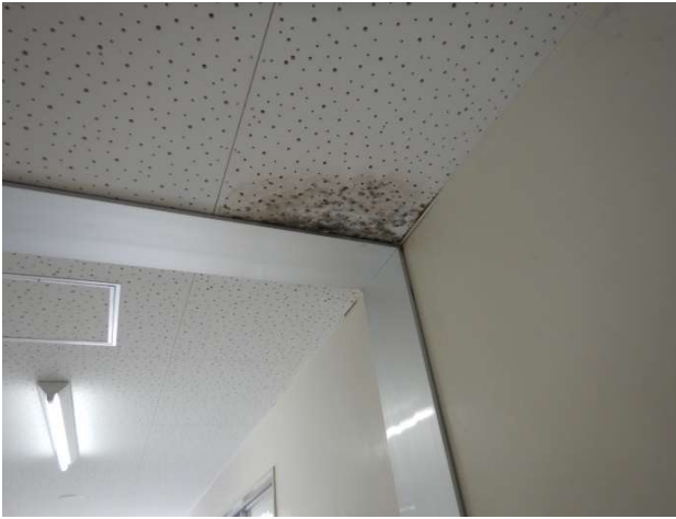
校舎棟のエキスパンション箇所に雨漏りの形跡が見られる。
