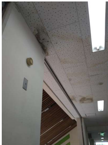
校舎棟の天井に雨漏りの形跡が見られる。
