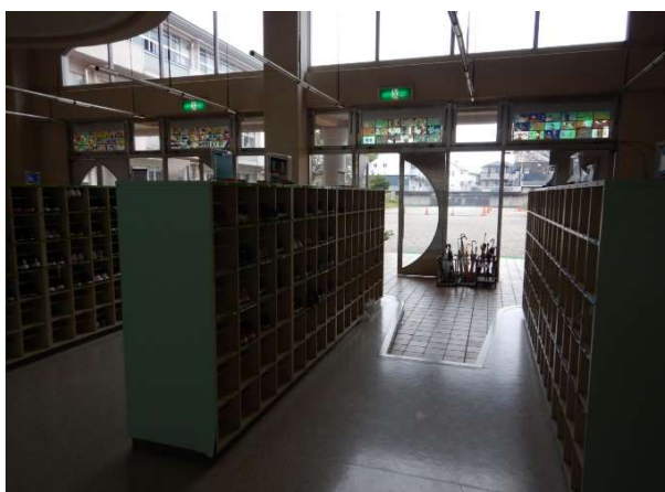
校舎昇降口のタイルに浮きが見られる。
