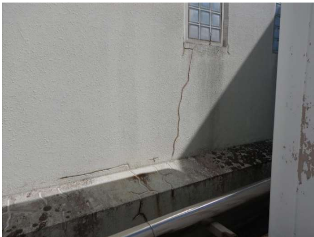
校舎棟の外壁にクラックが生じている。
