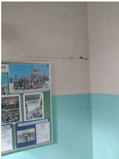
校舎棟の階段室にクラックが生じている。
