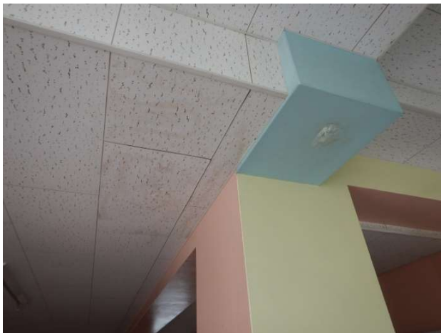
校舎棟の天井に雨漏りの形跡が見られる。
