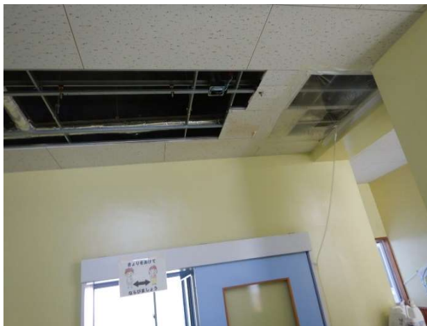
校舎棟の天井から雨漏りがあり修繕対応を行った。
