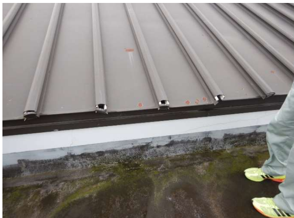
校舎屋根端部に経年劣化による破損が見られる。
