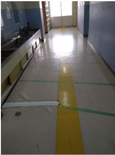
校舎通路の塩ビシートに浮きが見られる。
