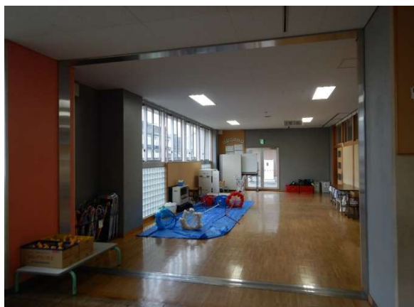
校舎通路の床に経年による劣化が見られる。
