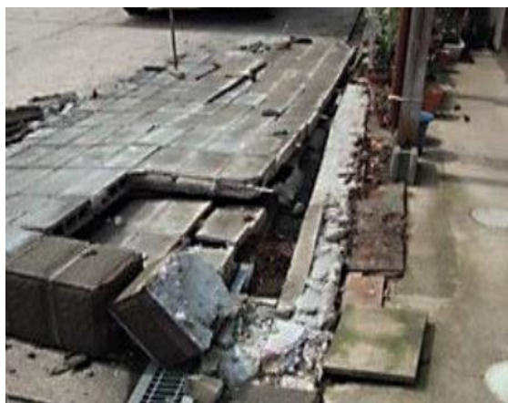
倒壊したブロック塀(参考写真)
