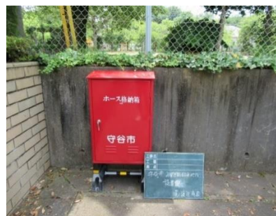
消火栓用器具格納箱
