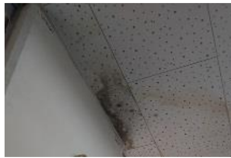
校舎天井 劣化状況
