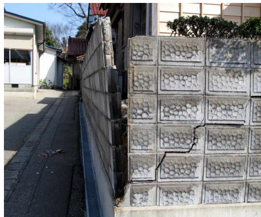
危険なブロック塀(参考写真)
