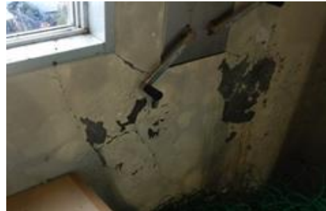
屋内運動場 内壁劣化状況
