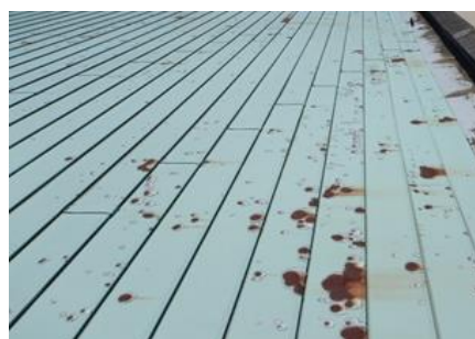
屋内運動場 屋根劣化状況
