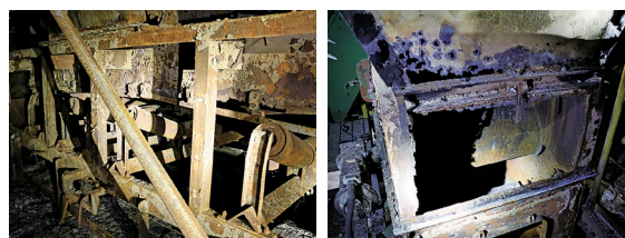
令和6年12月9日に発生した 常総環境センター資源化施設内火災後の様子
