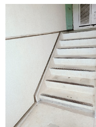
手すりが設置されていない市営住宅
