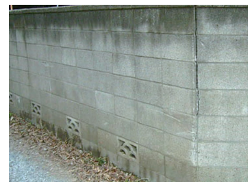
危険ブロック塀のイメージ
