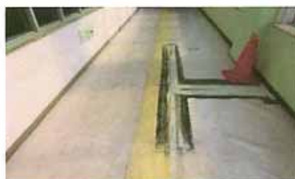
廊下床 劣化状況
