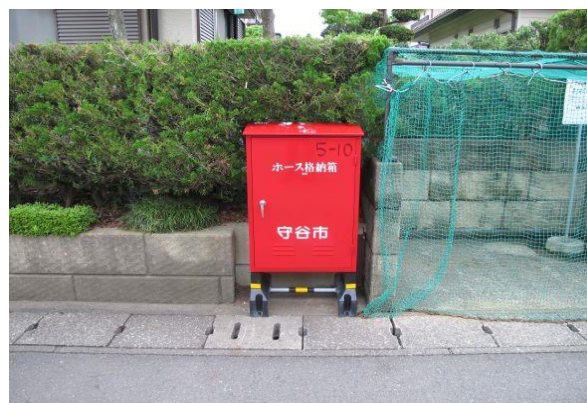
消火栓用消防用具格納箱(交換後)
