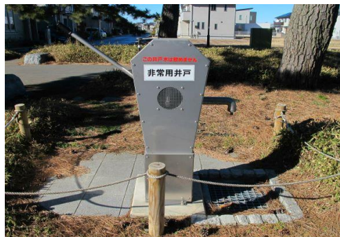
非常用防災井戸
