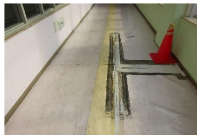
廊下床 劣化状況
