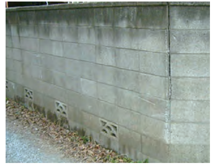
危険ブロック塀のイメージ
